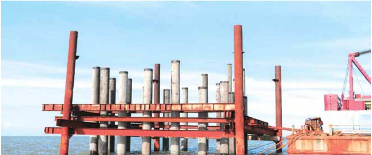
Điện gió Tân Thuận - EPC
