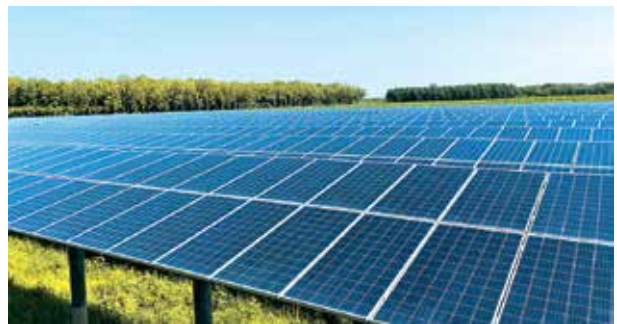
Điện mặt trời Dầu Tiếng 3 Mở Rộng (108MWp)
