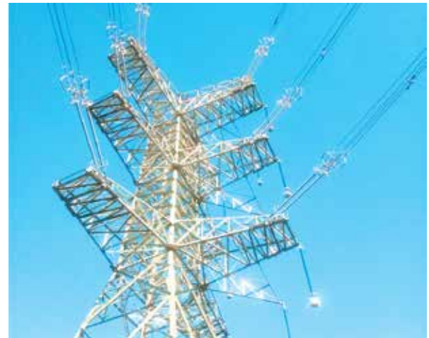
Cột đầu nối TBA 500kV Duyên Hải GóI EPC NMĐ Duyên Hải 2
